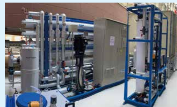
井水浄水装置 (361m 3 /日)
