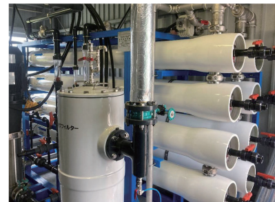
更新した井水浄水装置
